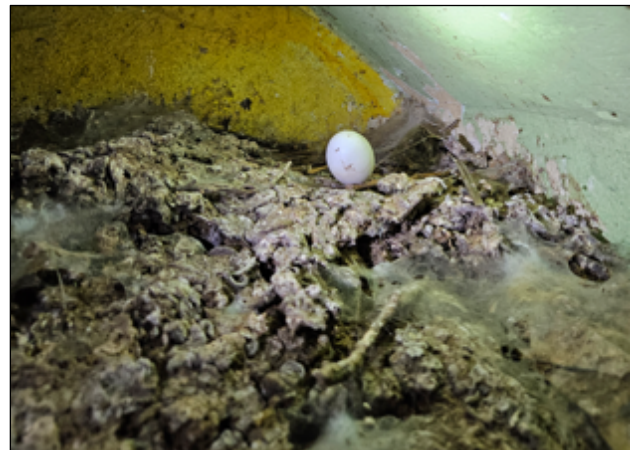
Figur 32. Rede på loftet i Skibsgade 3
