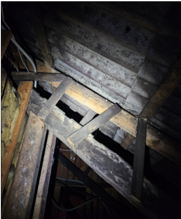
Figur 10. Tagkonstruktionen uden undertag eller isolering i bygningen på Adelgade 43
