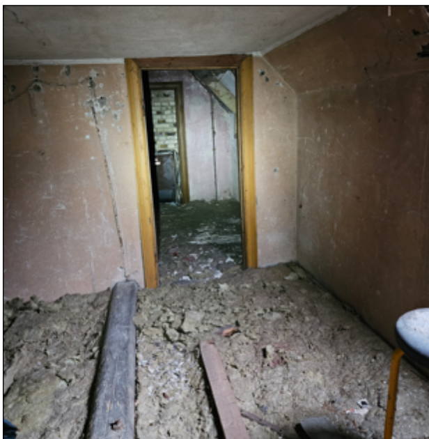
Figur 13. Gammel isolering på gulvet i gammel beboelse på loftet af Adelgade 45/Skibsgade 1
