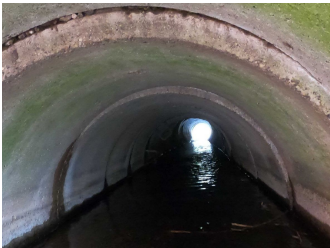
Figur 2. Forskydning mellem rørelementer.
