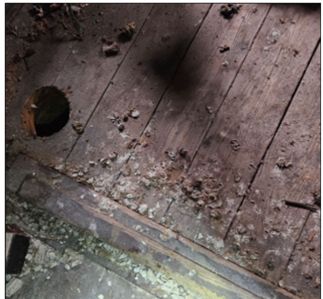
Figur 26. Fugleekskrementer på loftet i bygningen mellem Adelgade 43 og Nytorv 12
