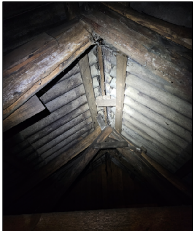
Figur 11. Tydeligt gammelt tømmer uden undertag eller isolering i Adelgade 43
