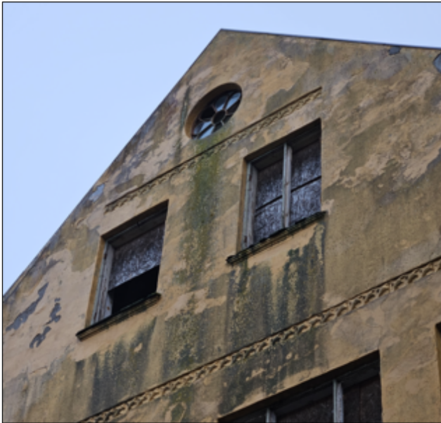
Figur 29. Åbne og smadrede vinduer ved facaden til Skibsgade 3
