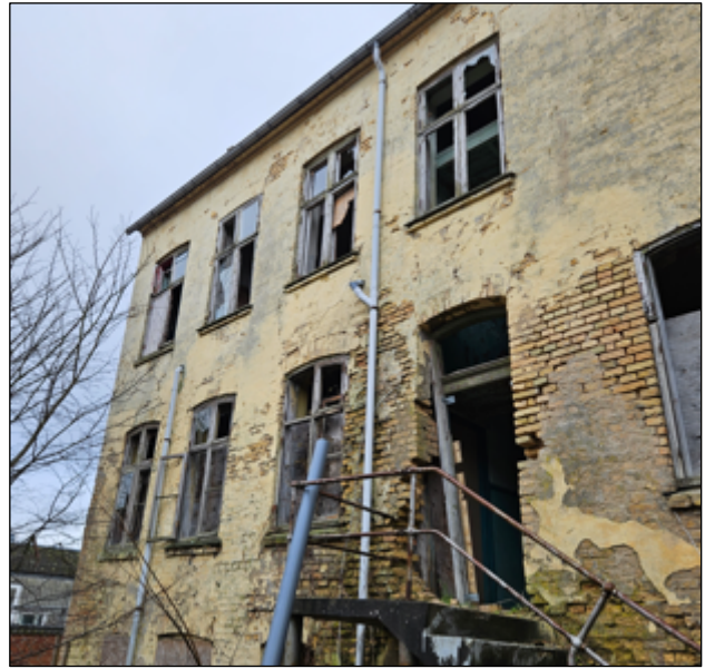
Figur 30. Åbne og smadrede vinduer ud mod gården ved Skibsgade 3
