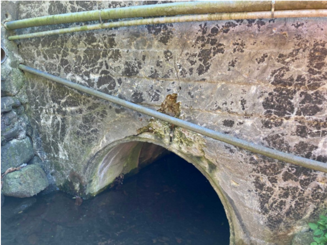
Figur 2. Nedbrydning af rør og fløjmur.
